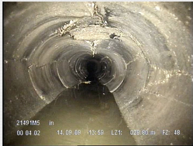
Bild 1: Einbrüche im Rohrscheitel des Betonkanals
